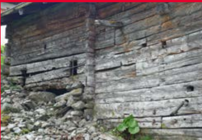
Zustand des Fundament-Trockenmauerwerkes vor der Sanierung
